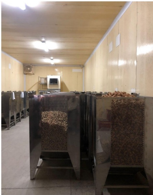
Sala de humidificación
